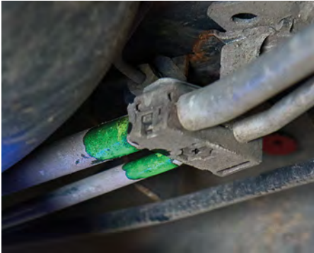
Odszukiwanie wycieku środka chłodniczego z klimatyzacji samochodowej po oświetleniu światłem UV i po zastosowaniu środka kontrastowego.
