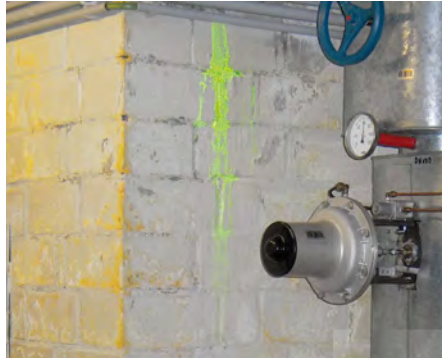
Lokalizacja nieszczelnego przewodu domowej instalacji hydraulicznej po wprowadzeniu uraniny i w trakcie kontroli UV.
