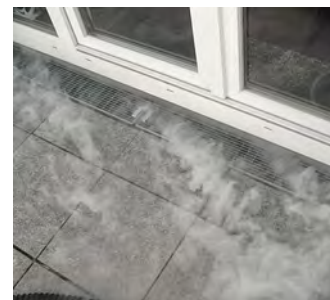
Nieprawidłowe uszczelnienie tarasu dachowego.
