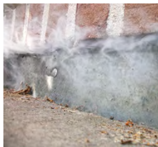
Dowód na nieprawidłowe uszczelnienie złączy ściennych powyżej garażu podziemnego.
