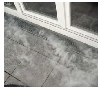
Fehlerhafte Abdichtung einer Dachterrasse.
