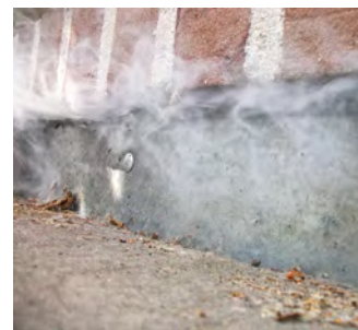
Nachweis schadhafter Abdichtung der Wandanschlüsse oberhalb einer Tiefgarage.
