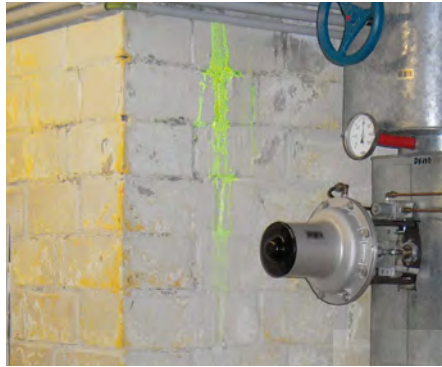
Ortung einer undichten wasserführenden Leitung im Gebäude per Uranin-Einleitung und UV-Inspektion.
