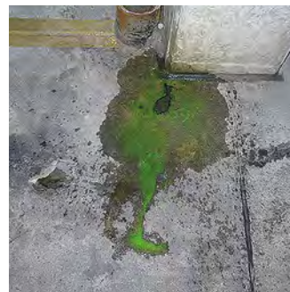
Uranin Green ist bereits mit bloßem Auge an der Austrittsstelle sichtbar und durch Fluoreszenzanregung mittels UV-Licht kann auch großflächig eine schnelle Tracerdetektion erfolgen.
